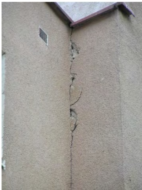
شکل ۱،۱ خرابی موضعی در محل تماس (Kaliningrad زلزله ۲۰۰۴)
