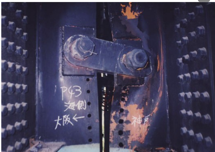
شکل ۱-۴- صدمه رسیدن به قسمت انتهایی رو سازه سگمت پل، زلزله کوبه ۱۹۹۵
