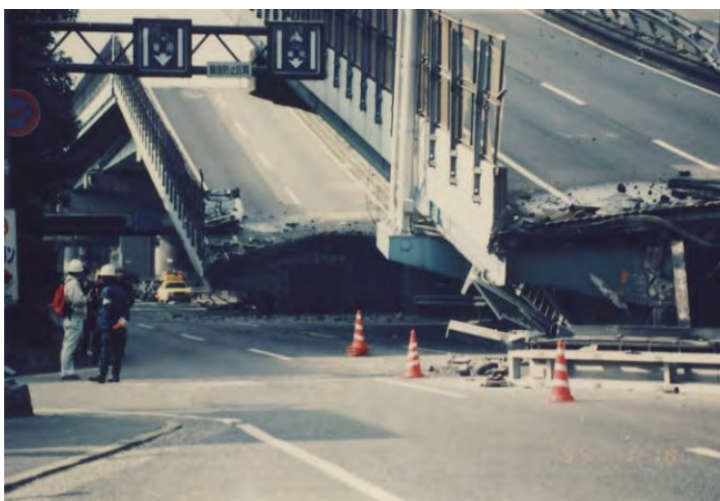
ضربه زدن به عنوان یکی از دلایل سقوط قطعات روسازه پل (زلزله کوبه، ۱۹۹۵)
